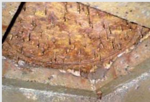
腐食したビルピットの蓋（裏面）
