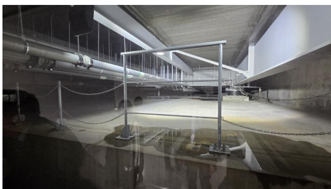
(伊丹市役所・免震装置)
